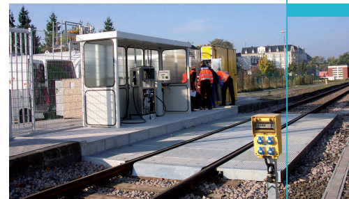
Tankstelle für Schienenfahrzeuge Wilhelmshaven
